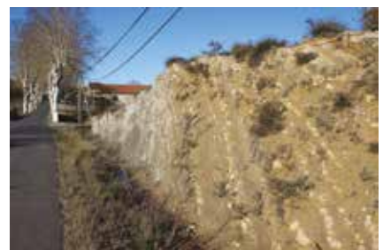
Talus argileux en bordure de route, village de N.-D.-de-Londres (Hérault) – Cliché W. Perrin
